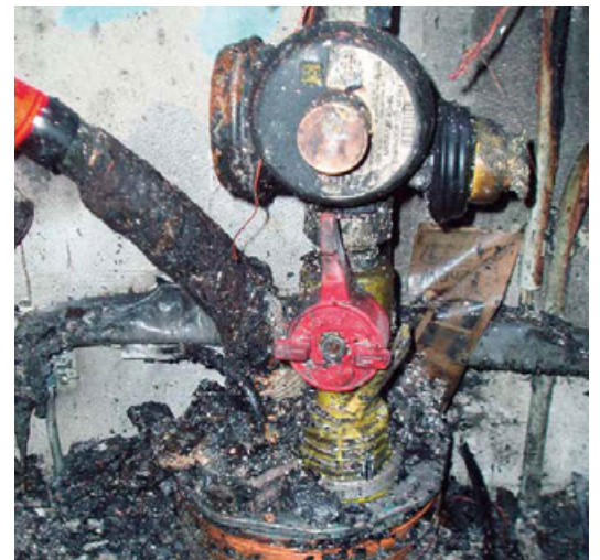
Abb. 2: Eine Gashauseinführung nach einem Brandfall in einem Einfamilienhaus: durch den Firesafe Griff wurde Schlimmeres verhindert.
