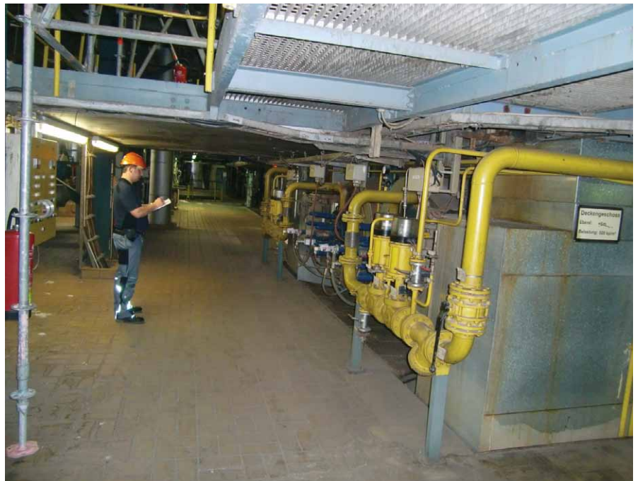
Foto: B.I.K. Anlagentechnik GmbH
